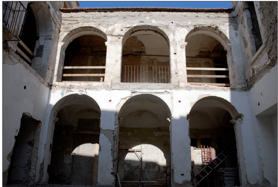
5. - Il chiostro del convento di Santa Caterina rinvenuto nel corso dei lavori di recupero (foto Fabio Iascone, Università di Foggia).
