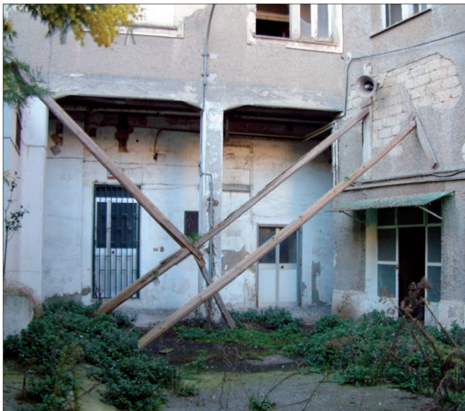
9. - Veduta della corte interna e di uno dei corpi di fabbrica degli ex Ospedali prima dei lavori di recupero; ora ospita la biblioteca e alcune aule del DISTUM (foto Fabio Iascone, Università di Foggia).
